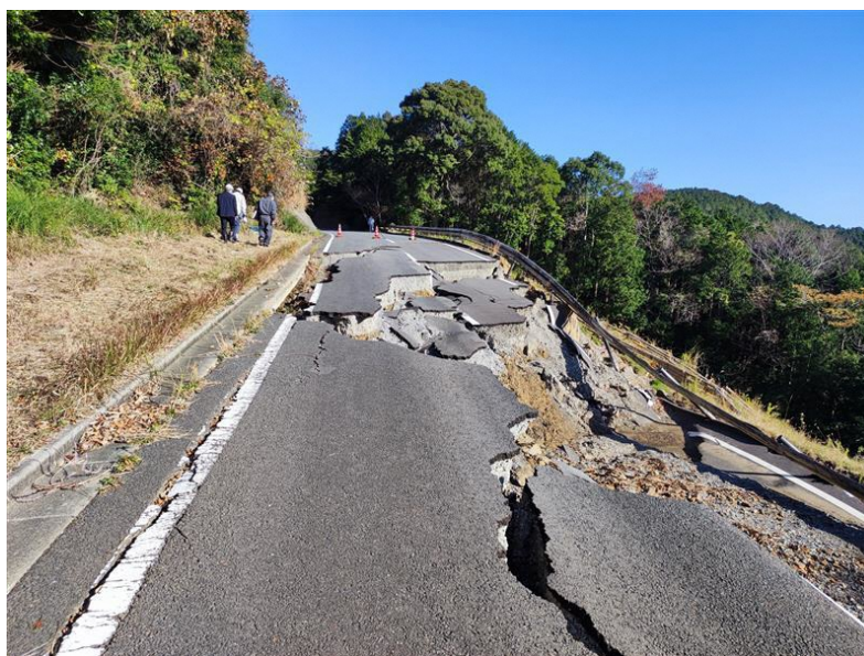
図2-10 西海市における被害状況(令和3年度)
