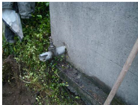
・ 防油堤のひび割れとバルブ
