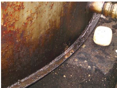
・ 重油タンクの腐食
