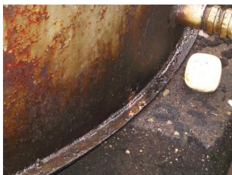
①. 重油タンクの腐食
