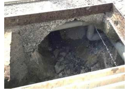
管路の漏水状況
