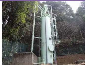
奉還地区浄水施設（2）
