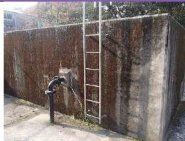
小松低部配水池
