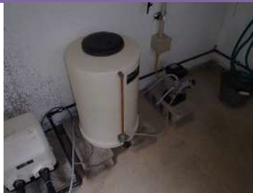
藤原地区浄水施設（2）
