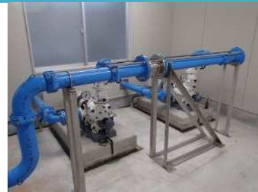
奥ノ谷送水施設（２）
