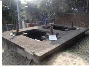
河通地区浄水施設（2）
