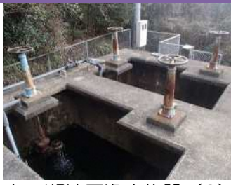
上ノ瀬地区浄水施設（2）
