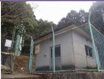
奉還地区浄水施設（1）
