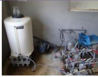
大瀬戸中部地区 浄水施設（2）
