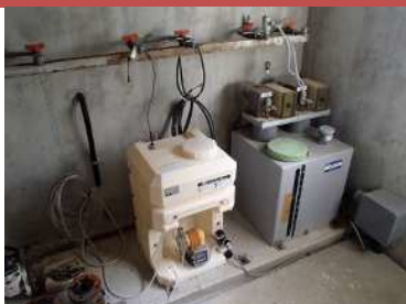
川山木場浄水場（2）
