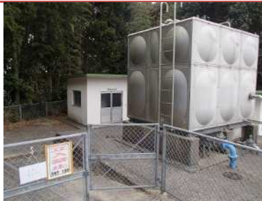
大石送水ポンプ所
