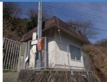
水浦送水ポンプ所
