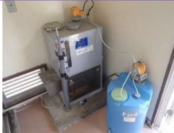
白樫地区浄水施設（2）
