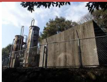
川山木場浄水場（1）
