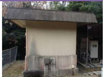
上ノ瀬地区浄水施設（1）
