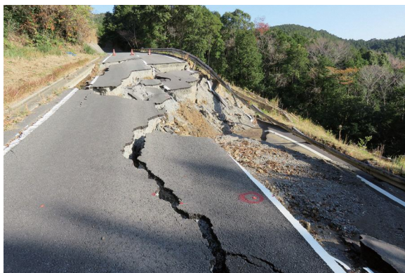
森林基幹道西彼杵半島線被災箇所（5号箇所）
