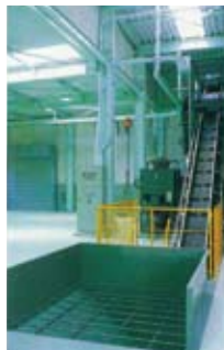
西海クリーンセンター内の不燃物処理設備
