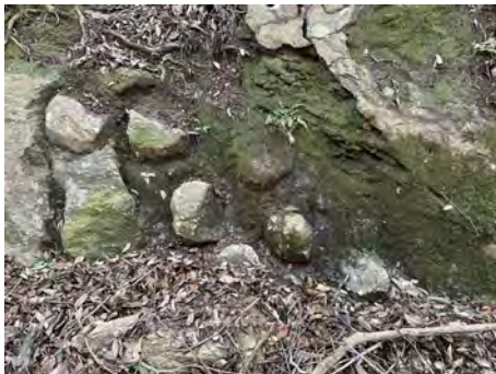
写真 5-12 コケの繁茂状況
