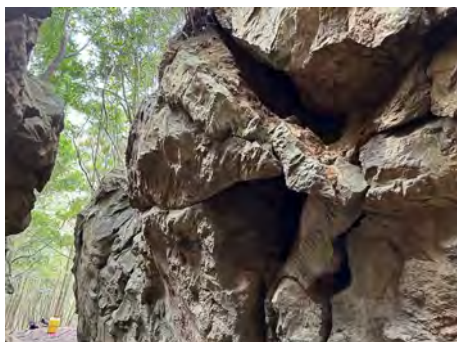
写真 5-18 崩落状況ならびに岩盤の亀裂状況
