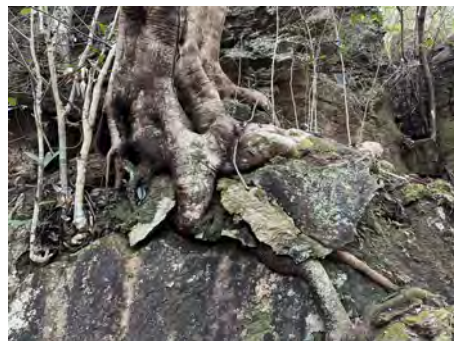
写真 5-21 木の根による破損状況
