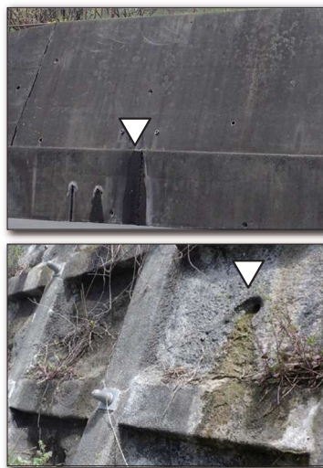
地下水の流出
