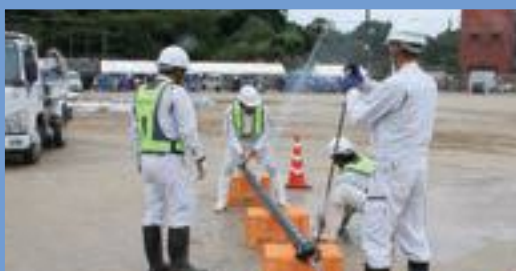
▲⑧水道管が破損し、上水道課からの要請を受けた管工事組が復旧活動を支援
