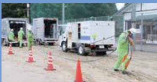
▲⑨九州電力が停電の発生を受けて配電用特殊車両を使用して送電
