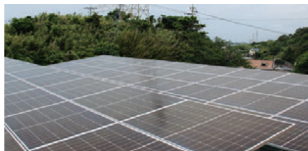
本庁舎屋上に設置した太陽光パネル
