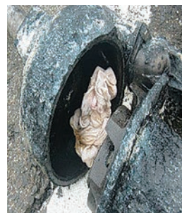
▲下水道管内で詰まっていた布切れ
