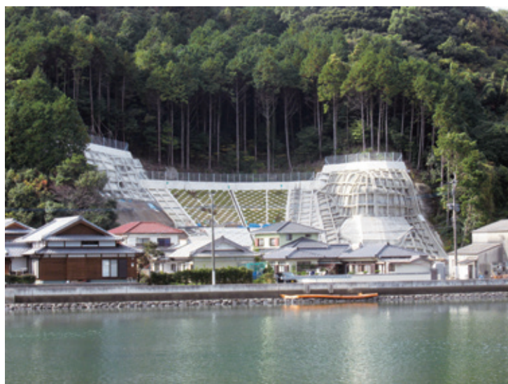
急傾斜地崩壊対策事業で整備された急傾斜
