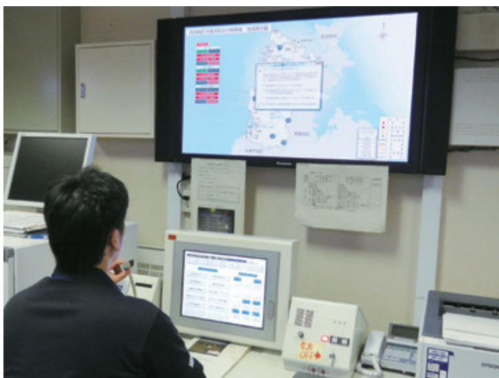
防災行政無線操作卓
